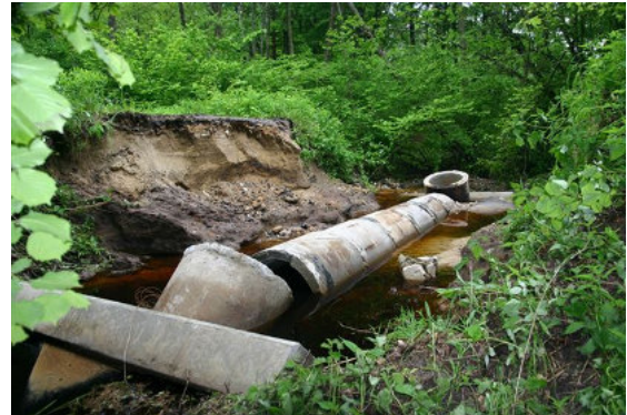
Straty powodziowe w 1997 r. – rozmyty przepust o zbyt małym świetle. W tym wypadku użyto zbyt małego przekroju do wykonania przepustu, jednak odpowiednie umocnienie budowli i umożliwienie przelania się wody górą przez przelew górny/bród nie dopuściłoby do takich zniszczeń. Źródło: Archiwum CKPŚ.
