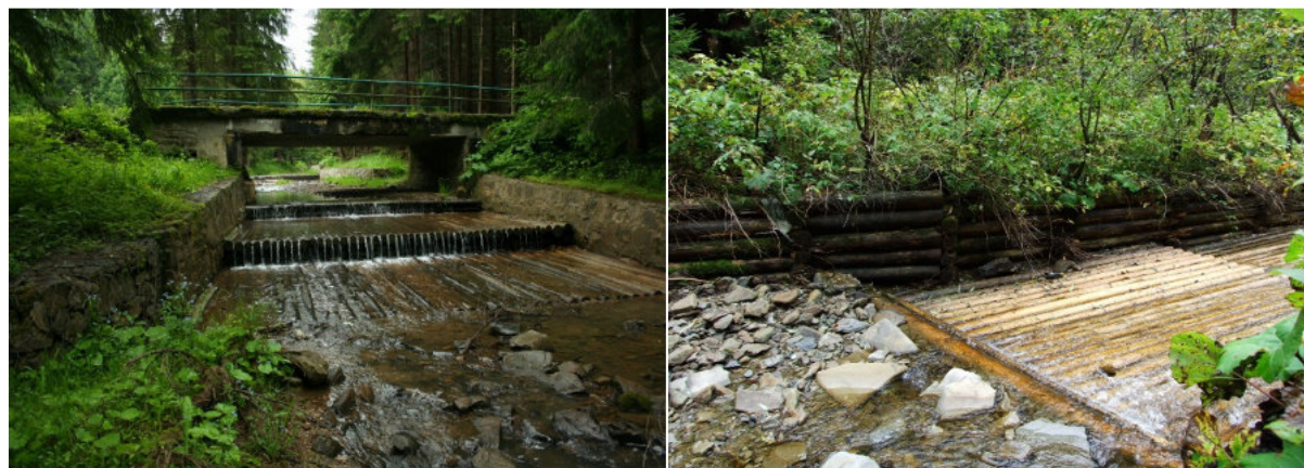
Stopnie wykonane z belek wzdłuż cieku przerywające ciągłość biologiczną. Źródło: Archiwum CKPS
