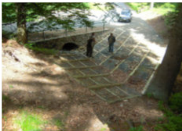
Kratownica drewniana poniżej przepustu pod drogą gminną – kratownica pełni rolę ubezpieczenia wypadu i jednocześnie brodu umożliwiającego wjazd droga leśna pod górę – Nadleśnictwo Zdroje fot. R.Majewicz
