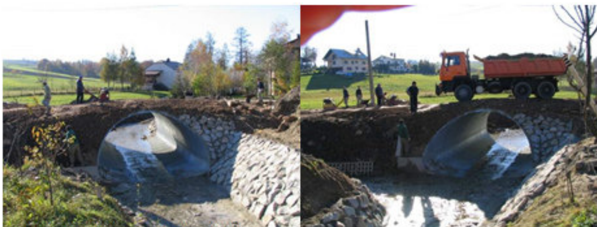
Przykłady adaptacji przepustów do zmian klimatu.
